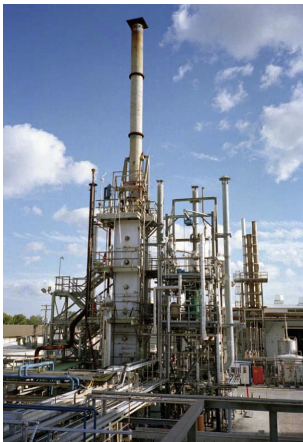
Fig. 20. Tubular reformer PDU.
